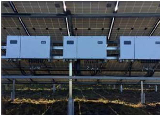
Exemple d'onduleurs « string » (source : BayWa r.e.)
