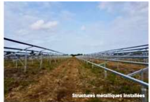
Structures installées (source : BayWa r.e.)
