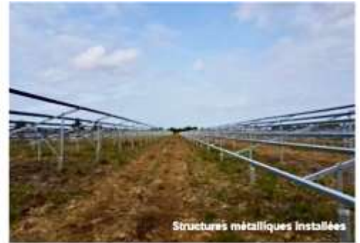
Structures installées (source : BayWa r.e.)
