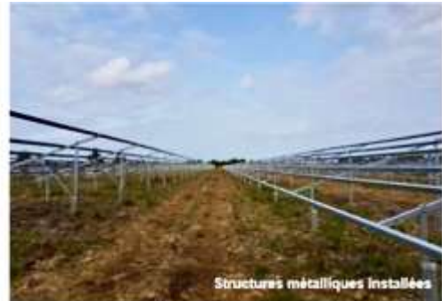
Structures installées (source : BayWa r.e.)
