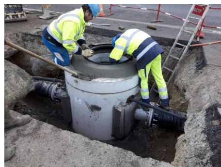
Regard d'accès pour le curage du réseau
