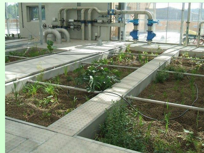
Station d'épuration Landry à Boulazac – Serre ORGANICA
